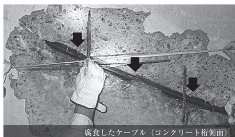
写真 - 2 PC 桁の損傷の例
