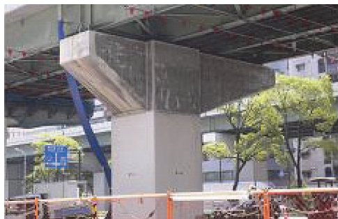
写真 - 5 ASR 損傷 RC 橋脚
