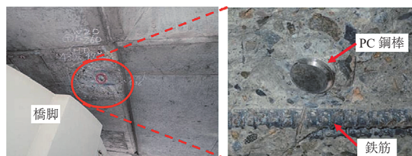
写真 - 2 鉛直 PC 鋼棒の破断に伴う損傷
