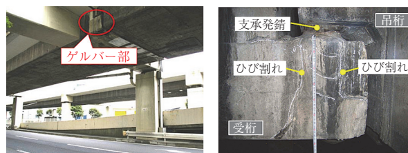
写真 - 1 ゲルバー部損傷状況
