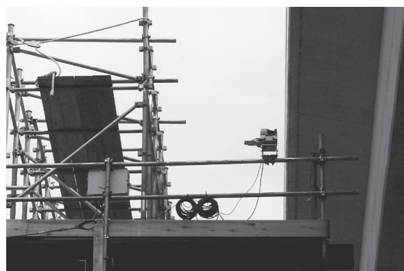
写真 - 5 レーザーバリアシステム設置状況
