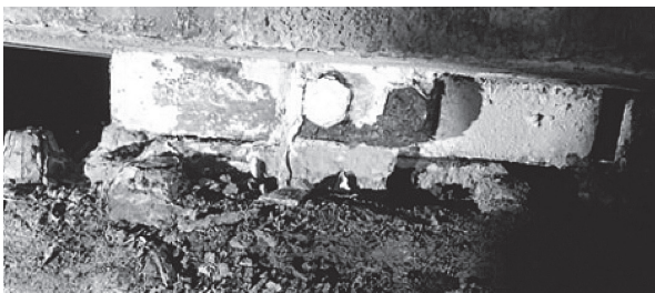
写真 - 1 ゲルバーヒンジ支承部の圧壊
