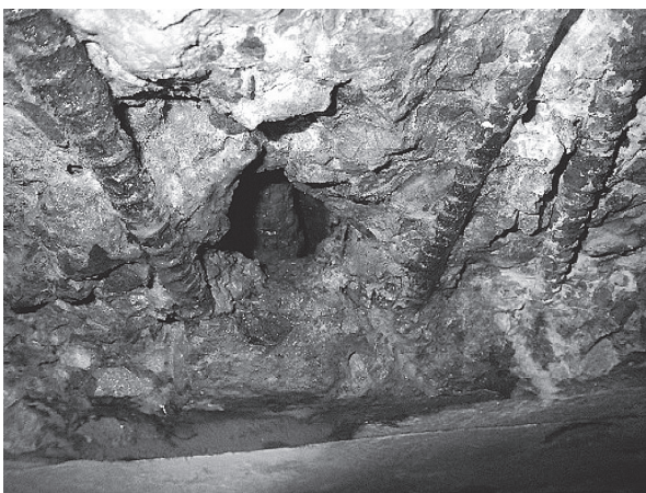
写真 - 2 横締め PC 鋼材のグラウト充填不良と PC 鋼材の腐食
