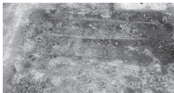
写真 - 2 床版上面の土砂化
