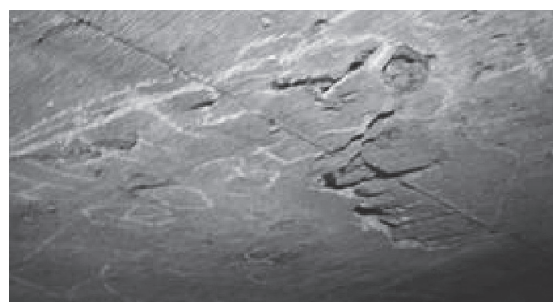
写真 - 1 床版下面のコンクリートの浮き剥離
