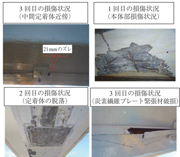
写真 - 1 損傷状況の変遷
