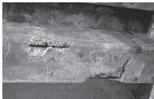
写真-1 主桁の損傷状況
