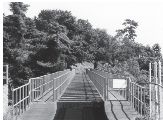
写真 - 2 小坂子第一水路橋の手すりのたわみ
