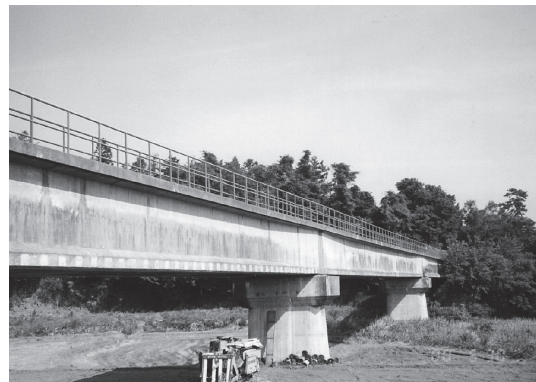
写真 - 1 小坂子第一水路橋のたわみ
