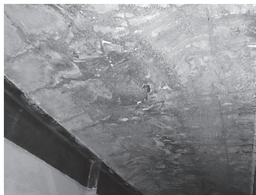
写真-1 床版下面の変状
