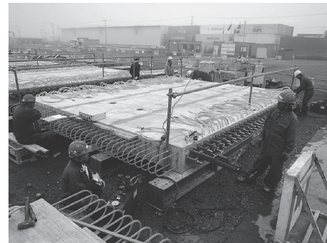
写真 - 4 CFRPを用いたPC床版(一体化後) (国土交通省北海道開発局釧路開発建設部提供)
