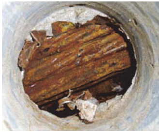
写真 - 9 シース管内のグラウト充填不良状況の例
