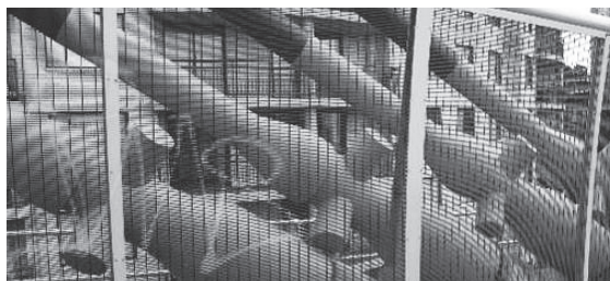
写真 - 17 ANZAC 橋の制振ダンパー
