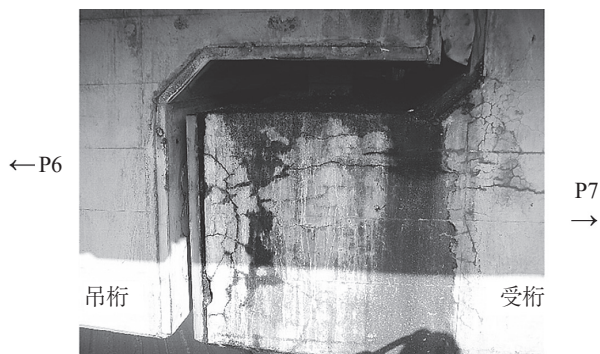
写真 - 11 ゲルバーヒンジ部の劣化状況
