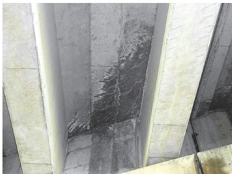
写真 - 1 床版の水しみ
