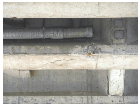
写真 - 3 排水管損傷による主桁の劣化
