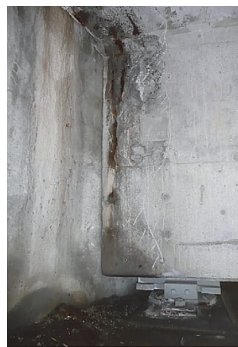
写真 - 2 桁端部の塩害劣化
