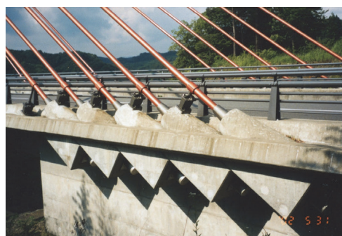
写真 - 5 斜材と粘性せん断ダンパー
