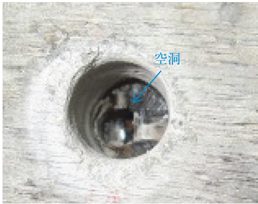
写真 - 4 PC グラウト未充填
