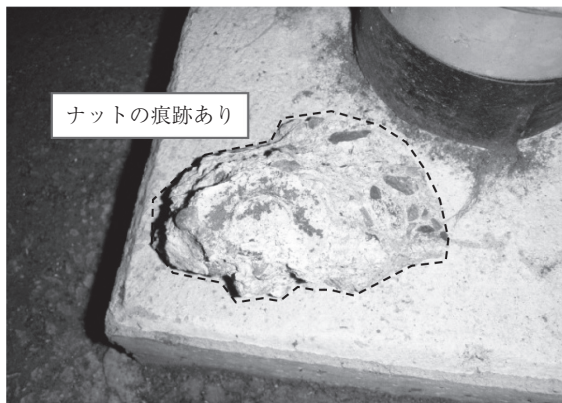
写真 - 2 PC 鋼棒突出によるコンクリート片
