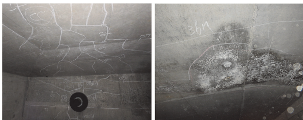
写真 - 1 床版下面（左：ひび割れ，右：遊離石灰）
