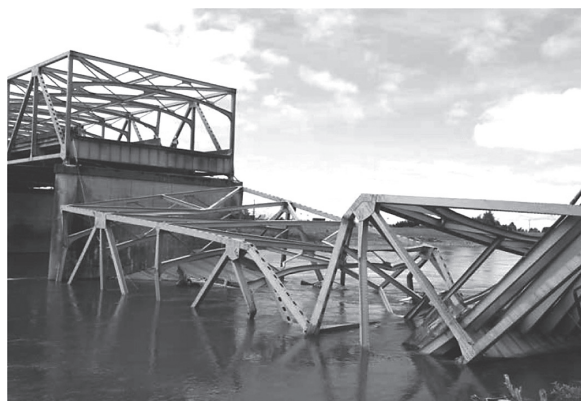
写真 - 1 崩落したスカジット川橋
