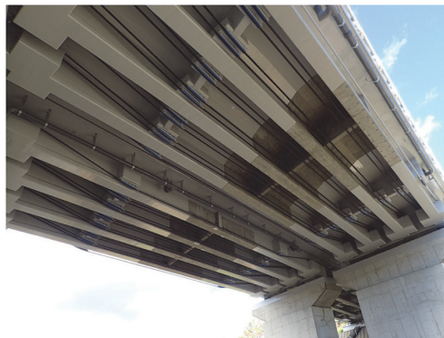
写真 - 13 外ケーブル配置状況
