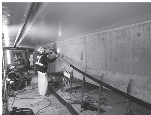
写真 - 3 外ケーブル配置状況
