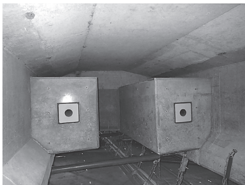
写真 - 2 外ケーブル定着装置
