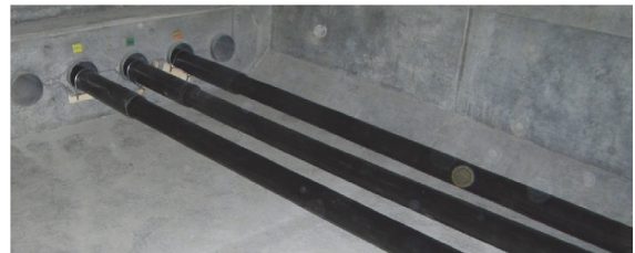
写真 - 7 外ケーブル (マルチエポキシ樹脂被覆ケーブル)
