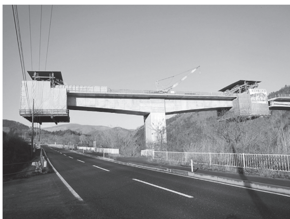
写真 - 3 国道上空 防護工
