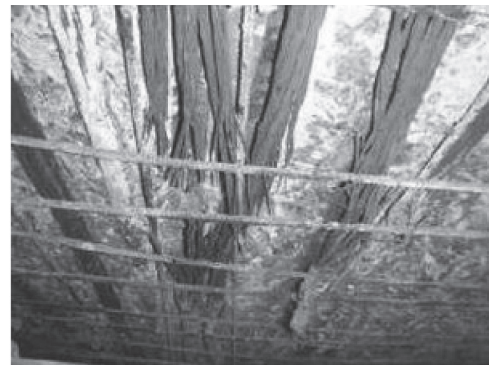
写真 - 1 PC グラウト充填不足により PC 鋼材破断事例 5)
