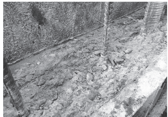
写真 - 12 過度のチップングによる打継目処理
