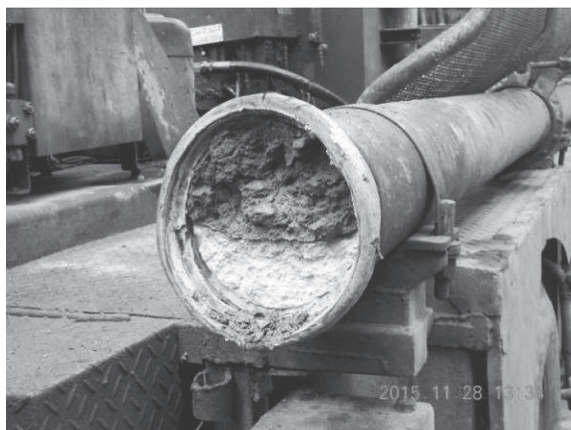
写真 - 4 ポンプ車の配管内のコンクリート
