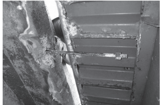
(a) 突出状況 1 (鋼棒の飛び出し)
