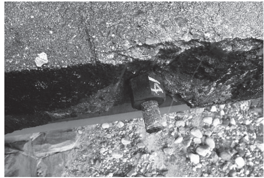
(b) 突出状況 2 (保護コンクリートの脱落)
