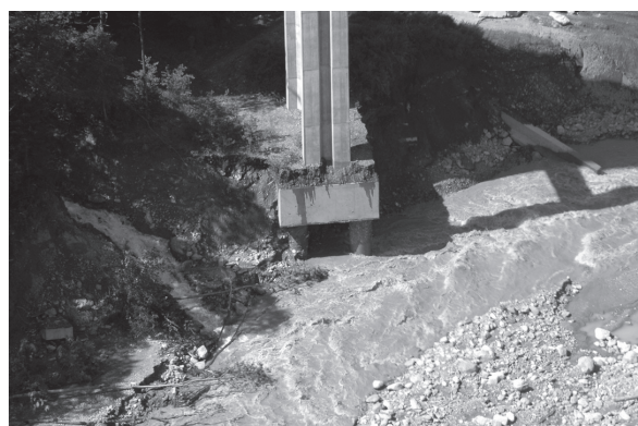
図 - 3 杭頭の露出（P3橋脚）
