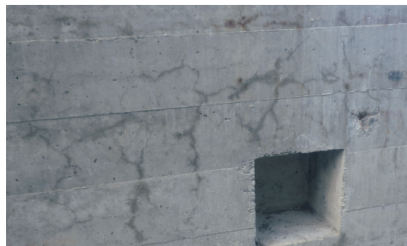
写真 - 4 橋脚のアルカリ骨材反応によるひび割れ
