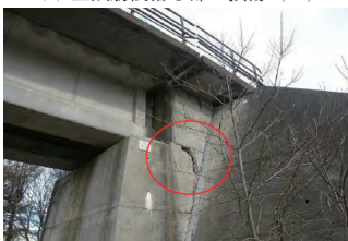
(e) 橋台バラベットの損傷
