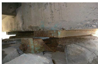
(c) 鋼製支承ピンプレートの損傷
