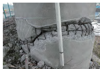
(c) 橋脚躯体の破壊
