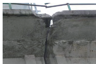
(d) 桁衝突による張出し床版の損傷
