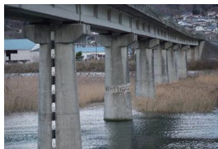
(b) 主鉄筋段落部の損傷 (P4)
