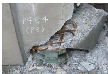
(b) 桁端のせん断破壊
