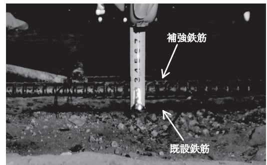
写真 - 2 断面欠損した既設鉄筋と補強鉄筋
