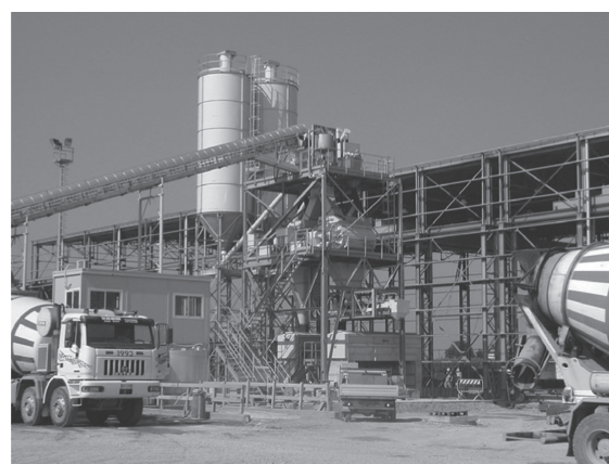
図 - 4 バッチャープラント
