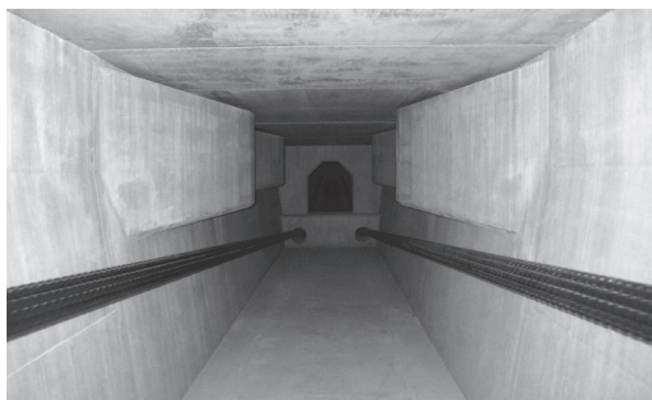
写真-9 外ケーブル配置状況
