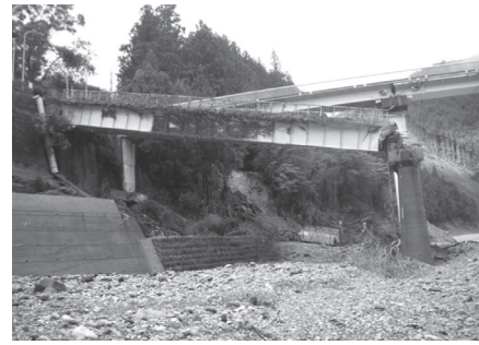
写真 - 10 崩落寸前の鈹桁橋(A1-P1径間)
