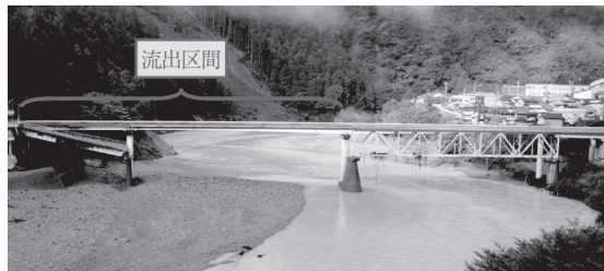
写真 - 1 折立橋の流出状況
