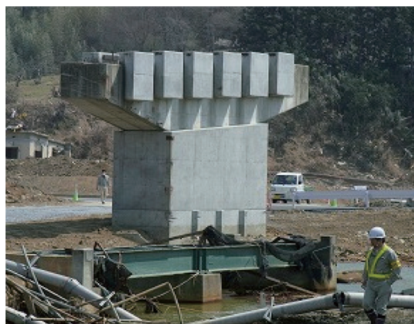
写真 - 8 アンカーバー（沼田跨線橋）
