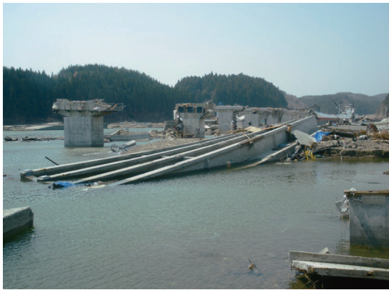
写真 - 12 ポストテンション T 桁の落橋状況（歌津大橋）
