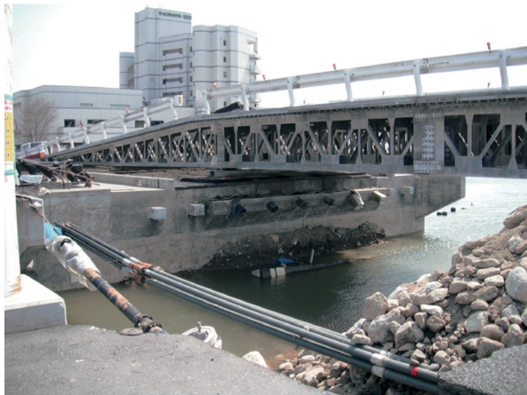
写真 - 4 橋台背面の土砂流出（川原川橋）
