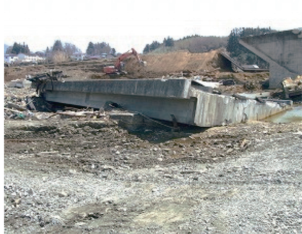
写真 - 6 落橋状況（沼田跨線橋）
