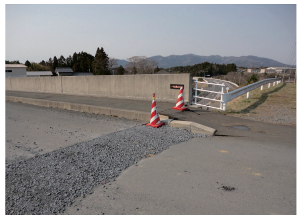
写真 - 2 段差の発生状況（15 cm）
