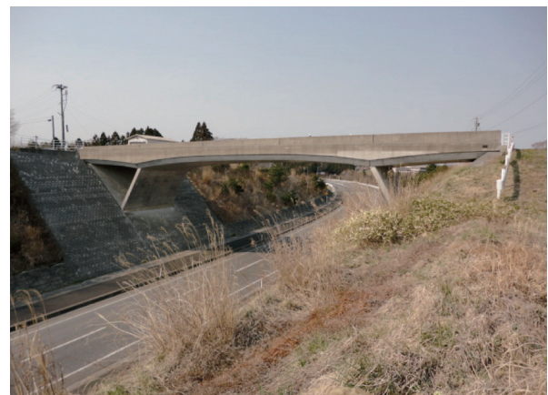
写真 - 1 橋面背面の段差が発生した PC 橋（全景）
