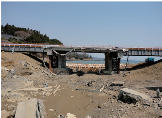
写真 - 10 橋台背面土砂の流出（二十一浜橋）
