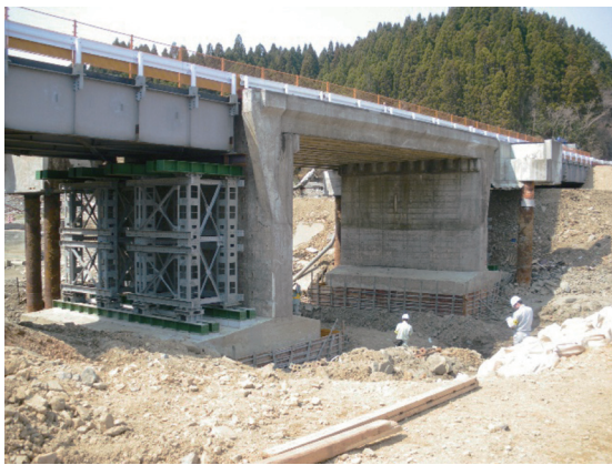
写真 - 9 主桁の落橋（二十一浜橋、手前の上り線）
