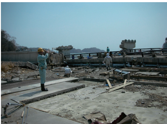
写真 - 13 プレテンション T 桁の落橋状況（歌津大橋）
