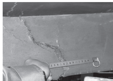
写真 - 9 最大変位時のひび割れ
