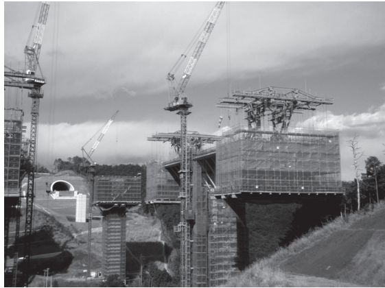
写真 - 18 大型移動作業車全景
