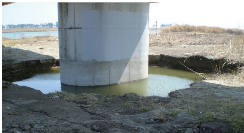
津波による橋脚廻りの洗掘
