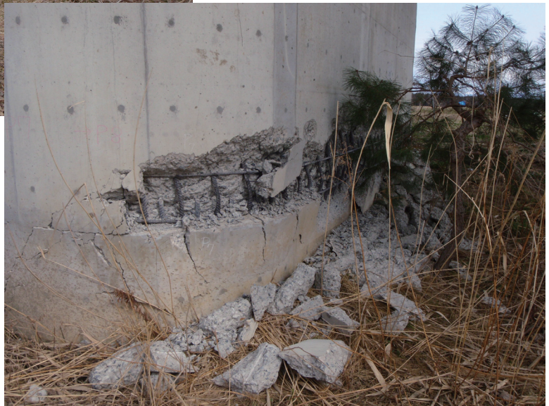
岩手県内陸部での地震動による橋脚柱の損傷
