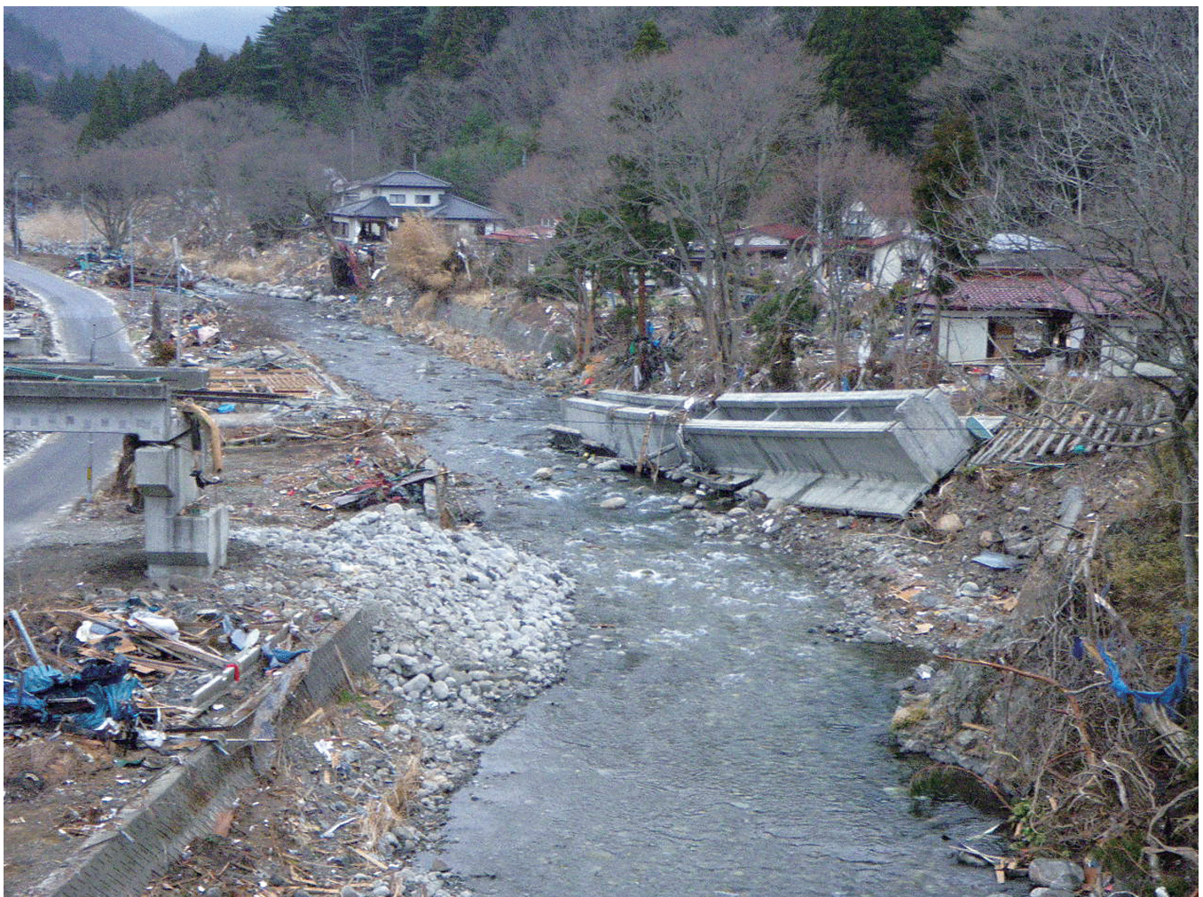
津波により流出した三陸沿岸部の PC 鉄道桁
