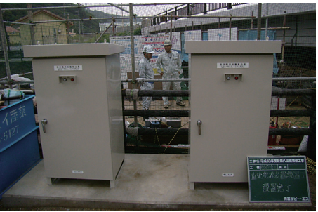
写真 - 11 直流電源装置
