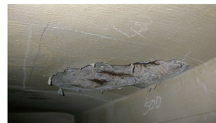
写真 - 4 損傷状況 (はく離: 主桁上フランジ)
