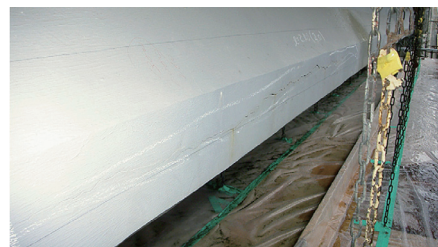
写真 - 3 損傷状況 (浮き: 主桁下フランジ)
