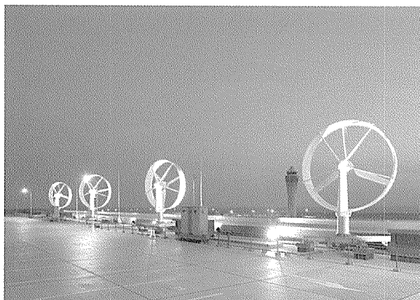
写真 - 20 屋上風車
