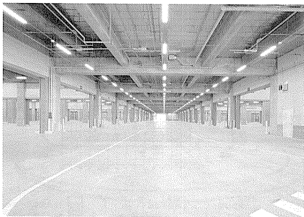
写真 - 19 倉庫内車路部分のスラブ状況
