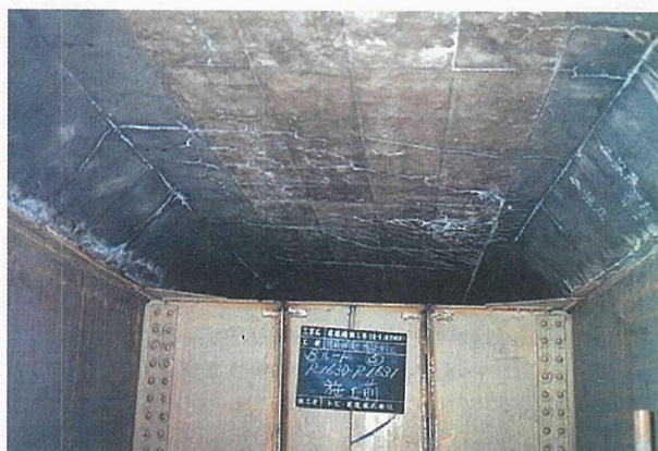
写真-6 コンクリート床版に発生したひび割れ損傷
