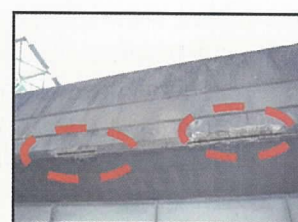
路外側（水切部の剥落）
