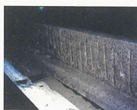
高速側（高欄の鉄筋露出）
