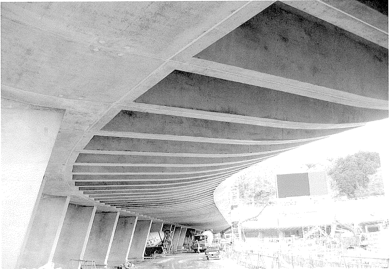
写真-7 片持ち CH 版の下面 — 迫力と意匠性を併せもつ特徴的な形状が実現した —
