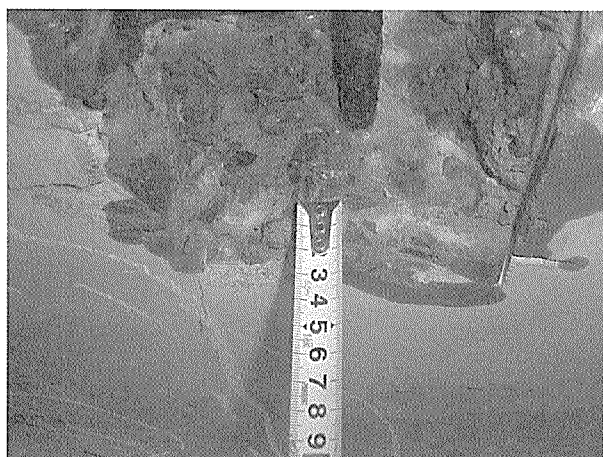
写真-1 はつり法による中性化深さ
