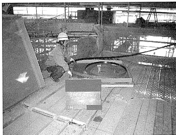
写真 - 4 アウトプレートの引き出し
