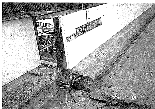
写真-1 ゲルバー桁の横ずれ（西宮 IC 橋）
