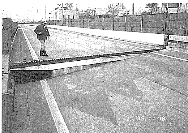
写真-4 ジョイント部に生じた段差（武庫川橋）
