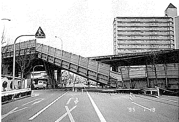
写真-2 落橋した瓦木西高架橋
