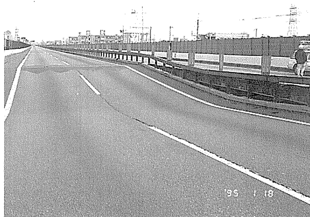
写真-7 路面の沈下（守部高架橋）
