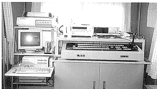
写真-3 中央制御室内のパソコンと中央制御盤
