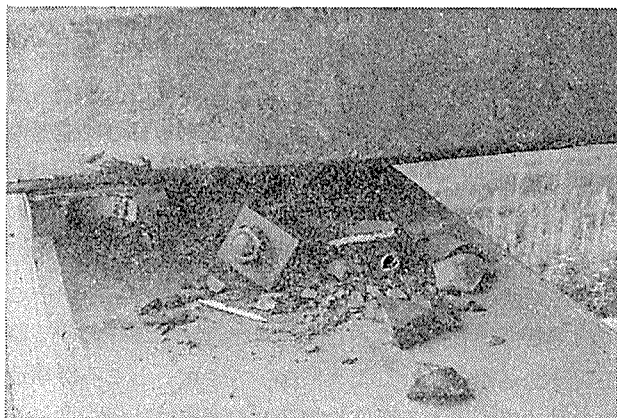
写真—2 PC 桁メタル支承の破壊 (1978 年宮城県沖地震)
