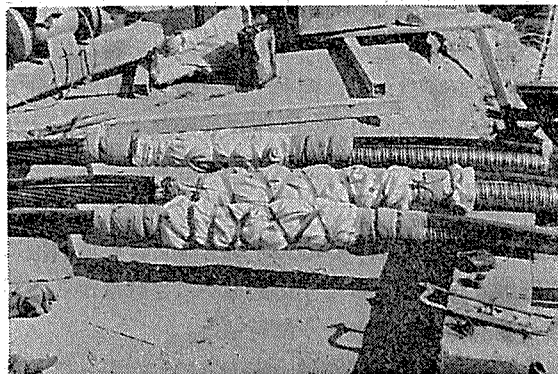
写真-7 アンカーケーブルのパッカー部
