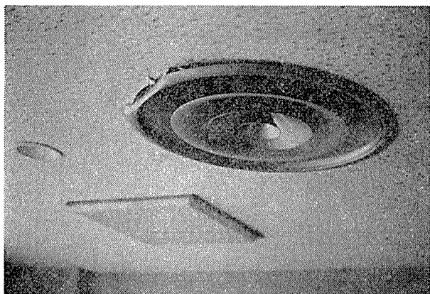
写真—2・b 七十七銀行天井の被害
