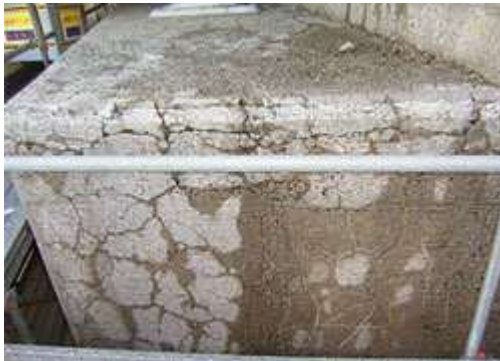
ASR等によるひび割れ
