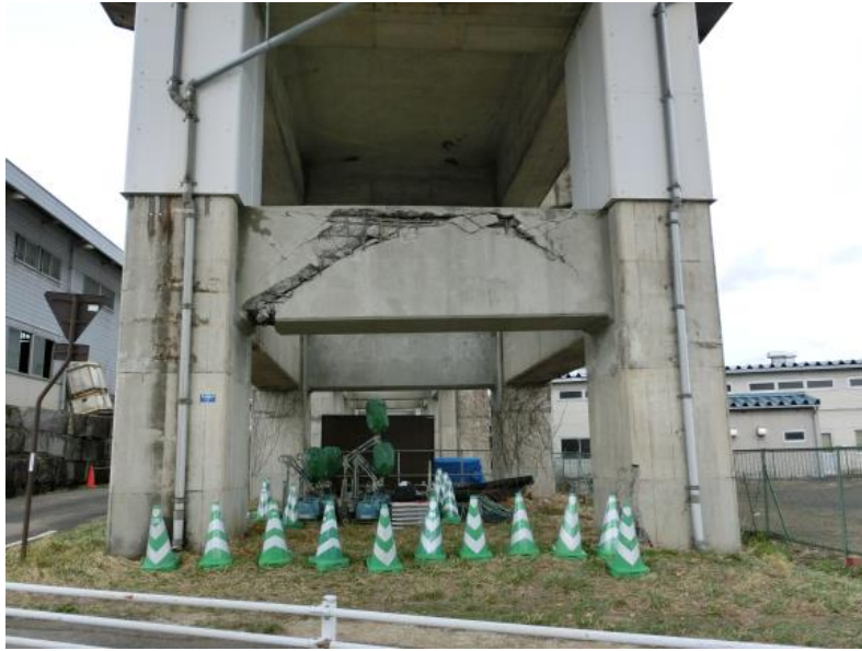
地震後の鉄道高架橋 (撮影者: 内藤)
