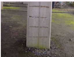
柱のかぶり不足の例
