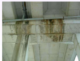
水掛かり箇所における変状例
