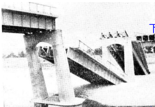
基礎・地盤の不安定
