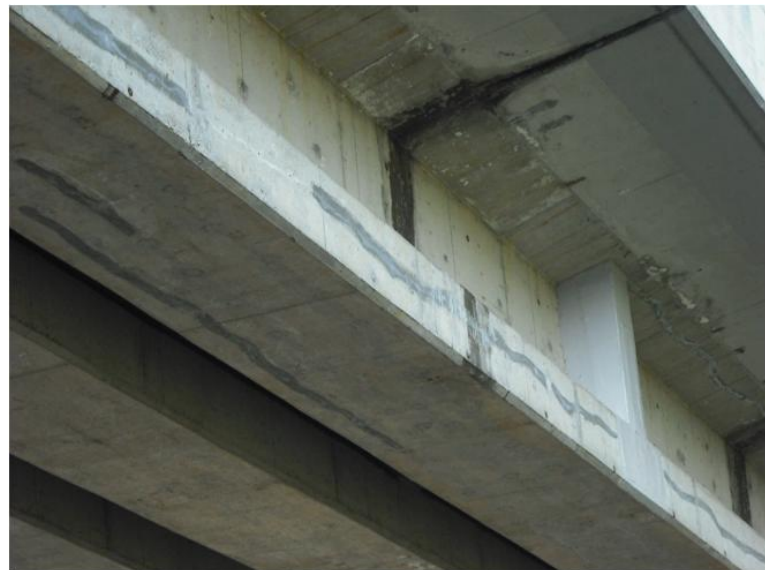
ポステンPCの軸方向ひび割れ発生事例
