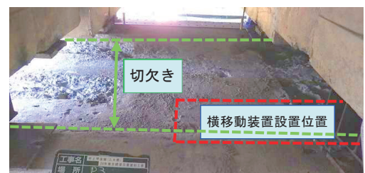
写真-3 橋脚天端の切欠き
